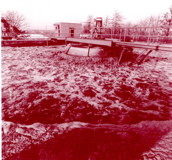
Rioolwaterzuiveringsinstallatie in Bunnik, 1987.
